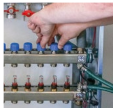
6. Nach Beendigung das Ventil schließen und gleichzeitig das nächste Ventil öffnen.
