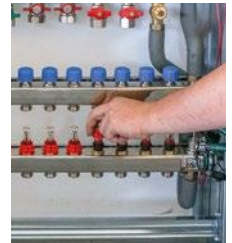
4. Plombierkappen abziehen und alle Durchflussmengenmesser öffnen.
