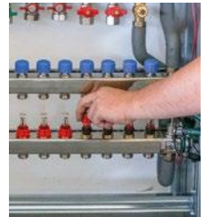
4. Plombierkappen abziehen und alle Durchflussmengenmesser öffnen.
