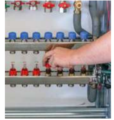
4. Plombierkappen abziehen und alle Durchflussmengenmesser öffnen.
