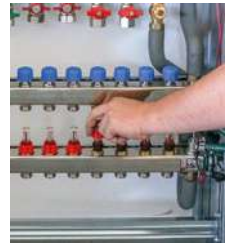
4. Plombierkappen abziehen und alle Durchflussmengenmesser öffnen.
