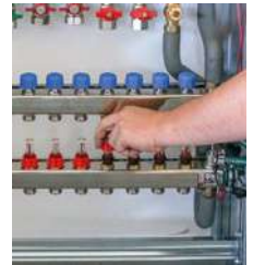
4. Plombierkappen abziehen und alle Durchflussmengenmesser öffnen.
