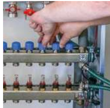
6. Nach Beendigung das Ventil schließen und gleichzeitig das nächste Ventil öffnen.
